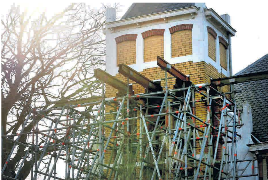
Een door gaswinning beschadigd gebouw in de steigers in Groningen. Foto: ANP
